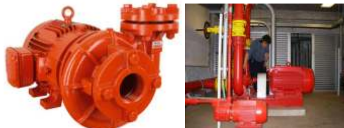
Fig. 17 - Bomba de incêndio
