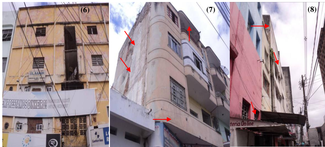
Figuras 6, 7 e 8- Vistas lateral e central dos Prédios com estruturas danificadas na Rua João Suassuna.
